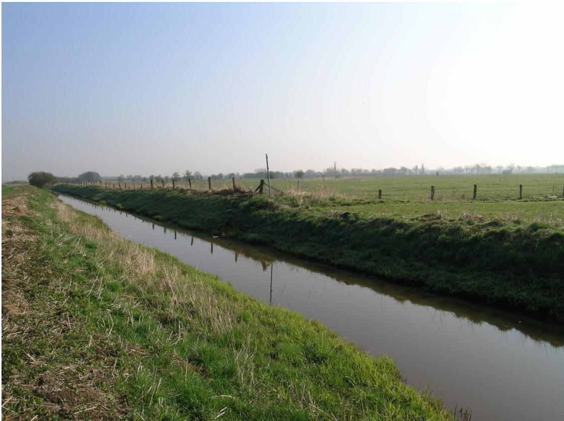
Abbildung 3: tiefer Bereich des rechtsseitigen Ufers (Foto aufgenommen am 10.04.2008 von Hr. Köhler, Gemeinde Stuhr)
